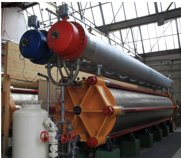
Obrázek 2: Alkalický elektrolyzér vody od společnosti IHT o výkonu 3,2 MW a kapacitě 760Nm 3 H 2 /h.
