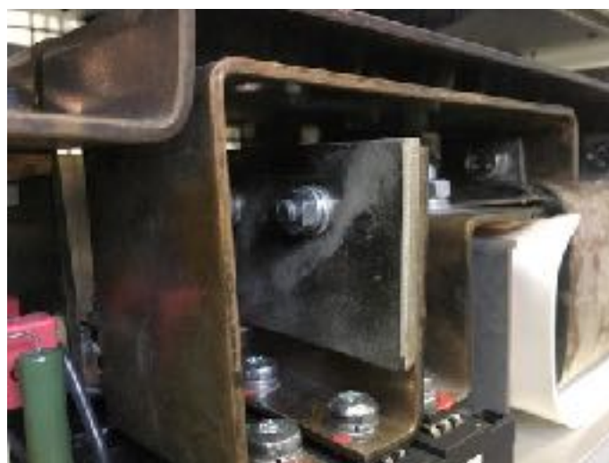
Obr. 1 - Výkonový zdroj po 2 týždňoch v galvanizovní
