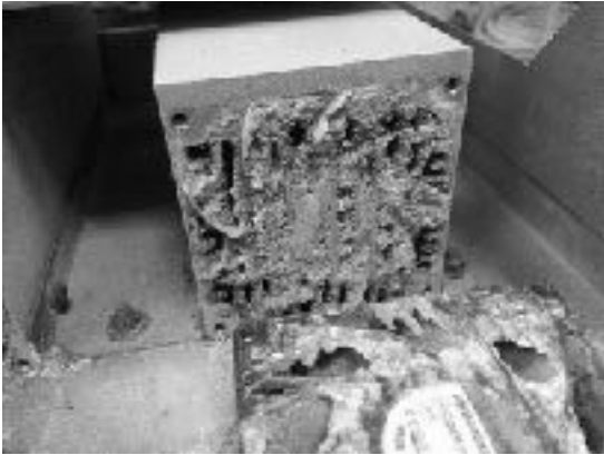
Obr. 2 Výkonový zdroj po 1 roku prevádzky
